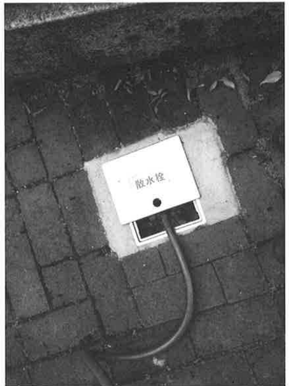
図11 新設した散水栓
