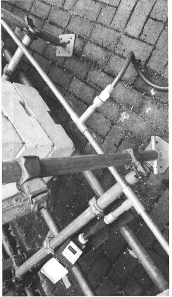
図12 散水栓から灌水コンピュータへの配管
