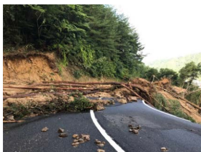
災害で起きた園内通路の土砂崩れ
